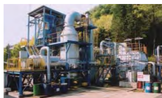
回収インフレーター作業処理設備
